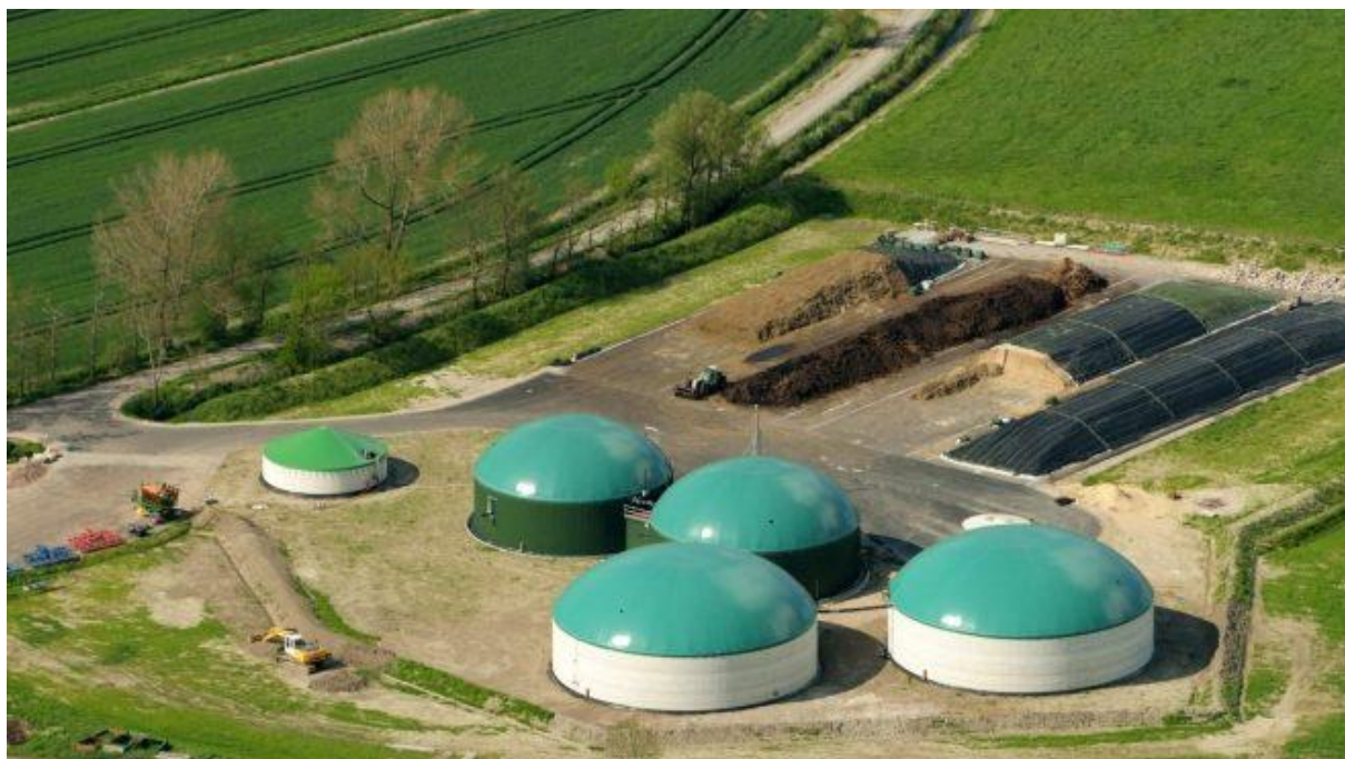
Figure 70 : Installation de méthanisation
